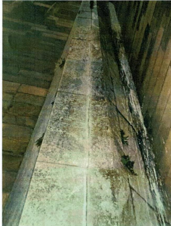
Sichtbare Schäden am Turm: abgewitterte Platten und stark bewachsene Fugen
