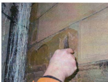
Verwitterter Sandstein muss ausgetauscht werden
